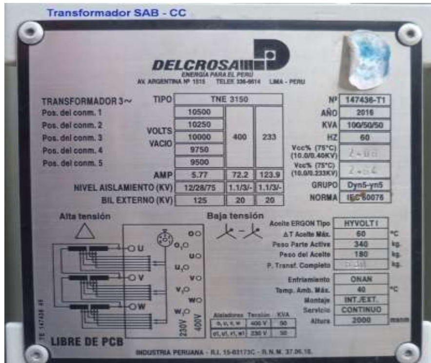
IMAGEN 05: placa de características transformador SAB L-10 KV – Bocatoma
